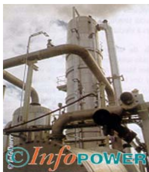
Imagen 3: Detalle de las torres de destilación
